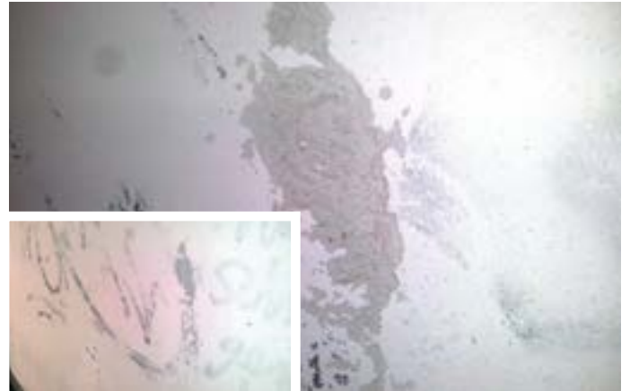
Abb. 17: Schäden an Putzschicht durch Wasser-Hochdruck
