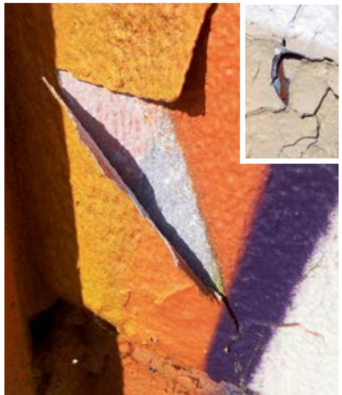
Abb. 14: Schäden durch Frost und Feuchtigkeit
